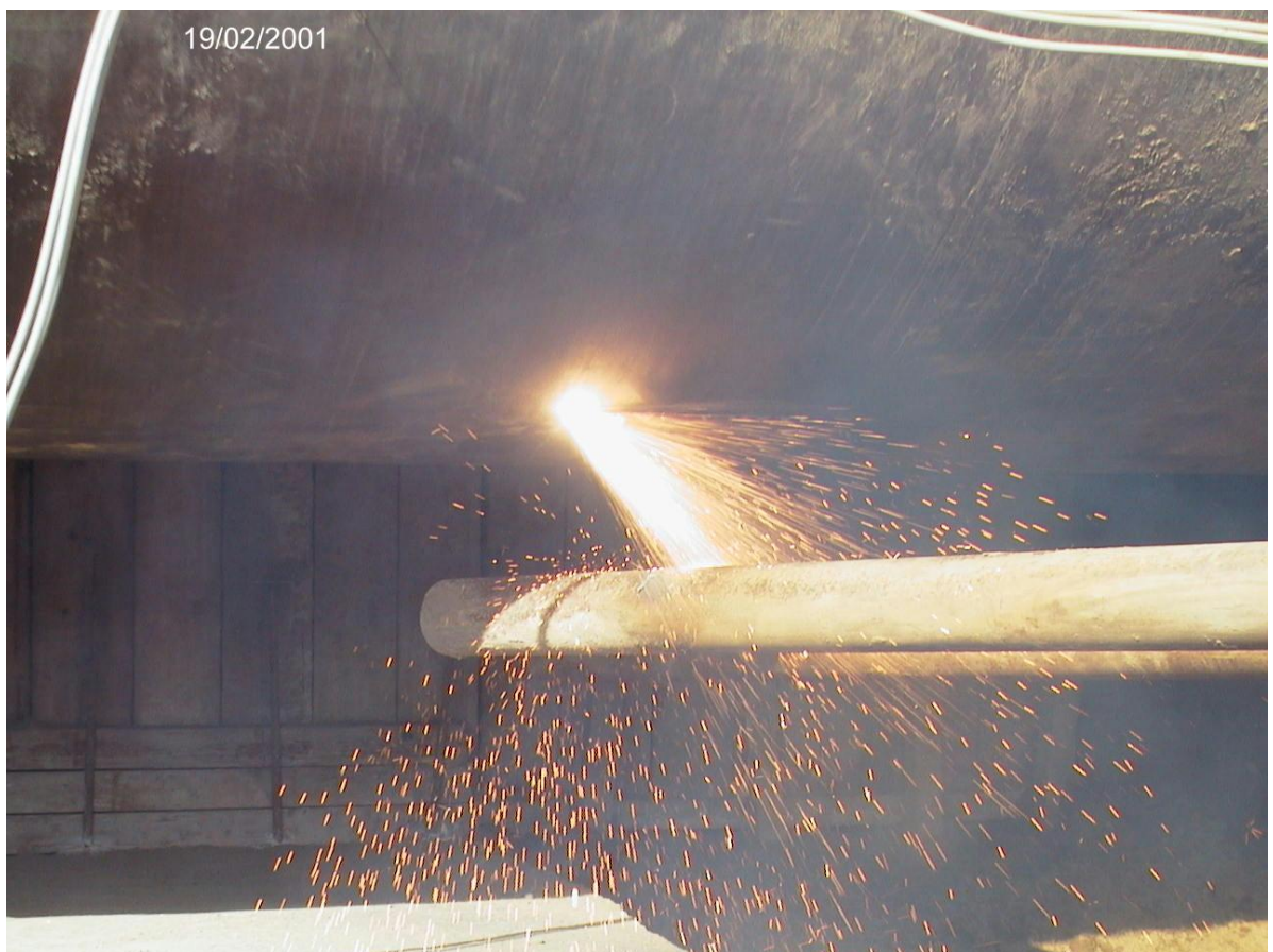
Fotografia n° 5 – Operazione prelievo parte danneggiata
