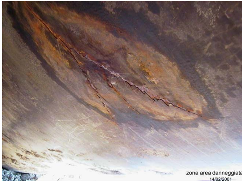
Fotografia n° 4 – Particolare cricca dall'esterno del serbatoio
