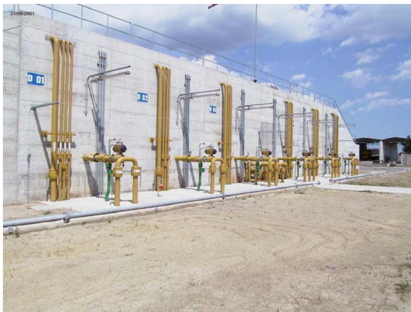
Fotografia n° 2 – Tumulo e tubazioni zona stoccaggio
