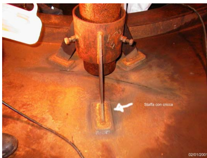
Fotografia n° 3 – Particolare cricca dall'interno del serbatoio
